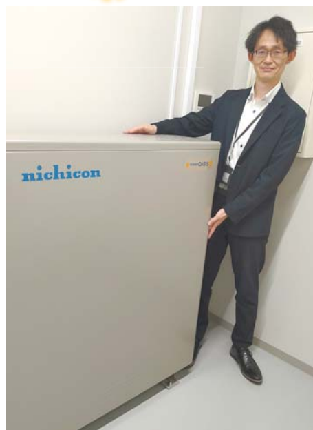
導入した蓄電池
