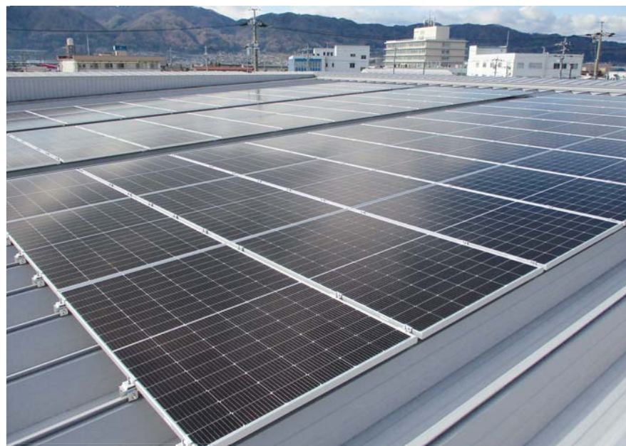
JA信州諏訪・諏訪支所に設置した太陽光パネル
