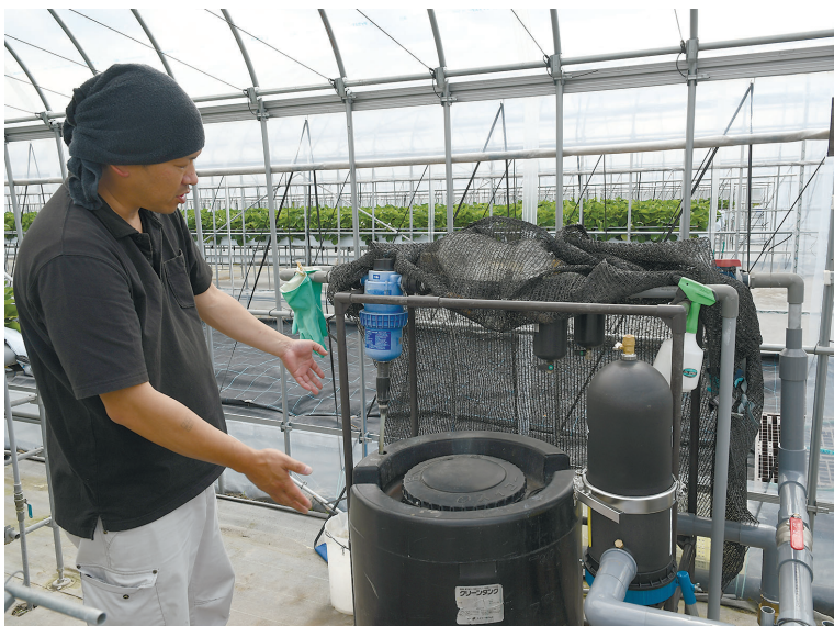
養液栽培の心臓部。右下から地下水をくみ上げ、フィルター(右の黒いタンクなど)を通して浄化。左の黒いタンクは液肥。混入器(上の水色部分)で液肥と浄化した地下水を混ぜて各ハウスに送り出す。送出作業はタイマーで自動化されている
